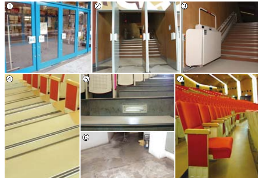
①鉄製で重い入口の扉 ②ホール入口の扉は遮音性が低く開口部も狭い ③車いす利用者がホール内に入るための設備は西側入り口（第4通路）に設置してあるリフト1基のみ ④客席通路の階段のステップ幅が違い、暗がりではつまづきやすい ⑤足元灯は非常灯機能が無く設置位置も悪い ⑥夏場はしばしば地下通路の床が浸水する ⑦前席との間が狭く、人が座っていると中ほどの席への移動はしづらい
