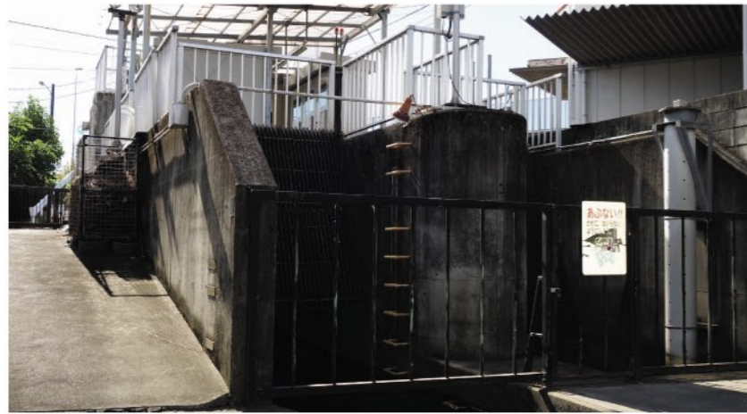
大型ポンプ2台と水門のある排水施設
