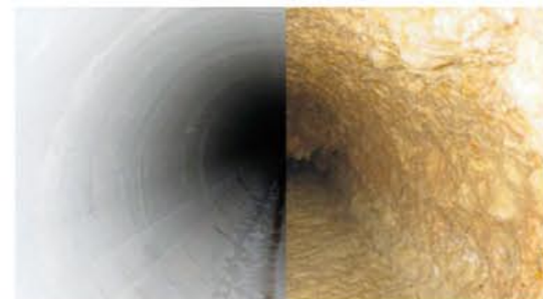
左：正常な下水道本管
