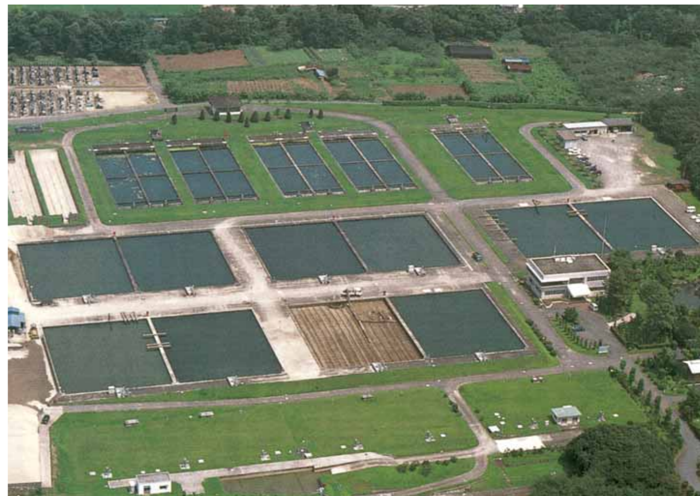
緩速ろ過方式で水を浄化している若田浄水場
