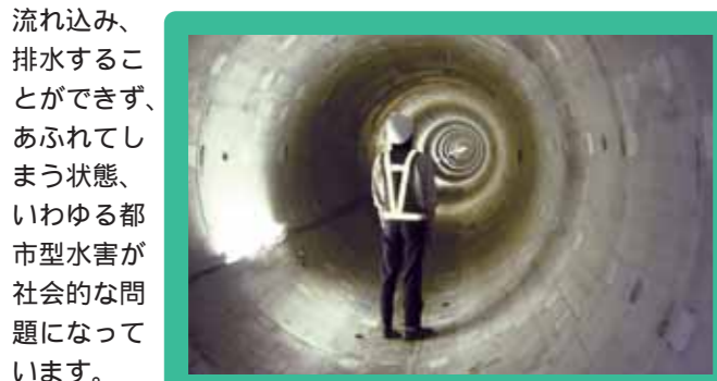
倉賀野地区に埋設されている大人でも立つことのできる巨大な雨水幹線 直径2.8m
