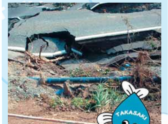
露出した水道管
