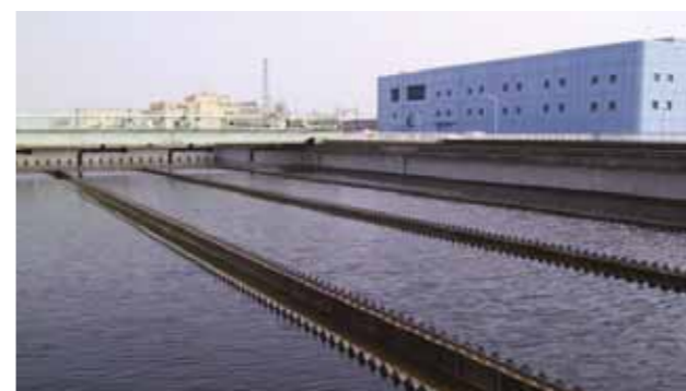
阿久津水処理センター 最終沈殿池
