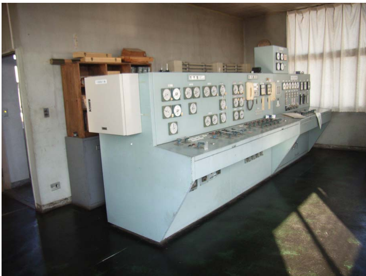
監視盤【21年度で更新予定】
