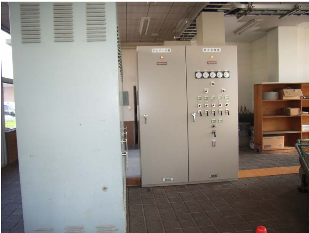
テレメーター盤・取水設備盤【20年度で更新済】
