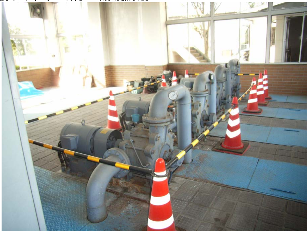
配水ポンプ(1系・4台)【21年度で更新予定】
