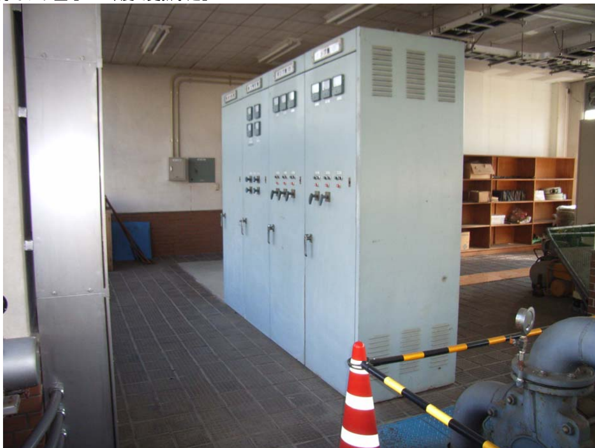
配水ポンプ盤【21年度で更新予定】
