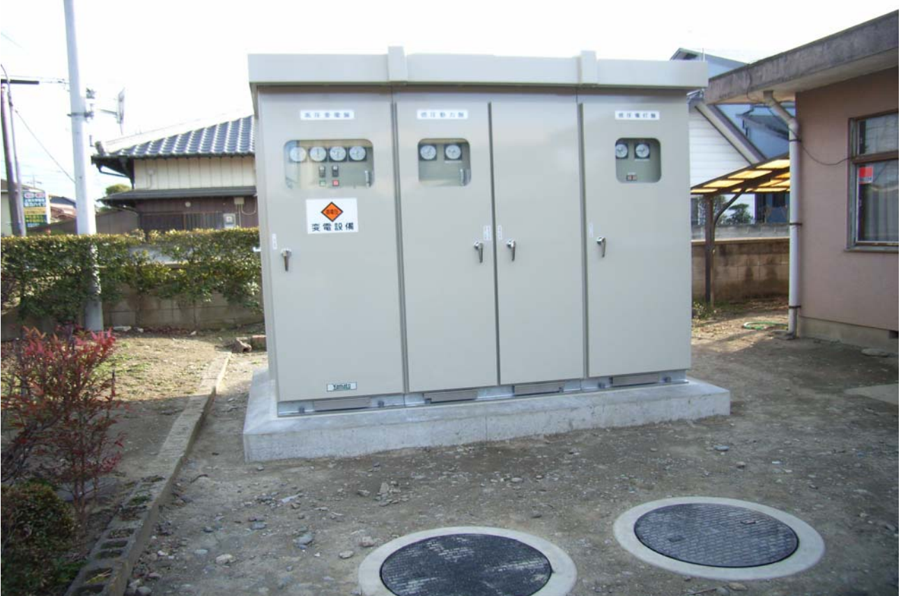
< 高圧受変電設備 >
