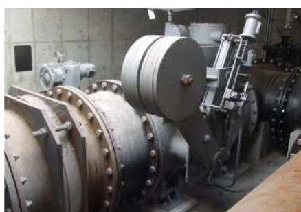
正観寺配水池内緊急遮断弁
