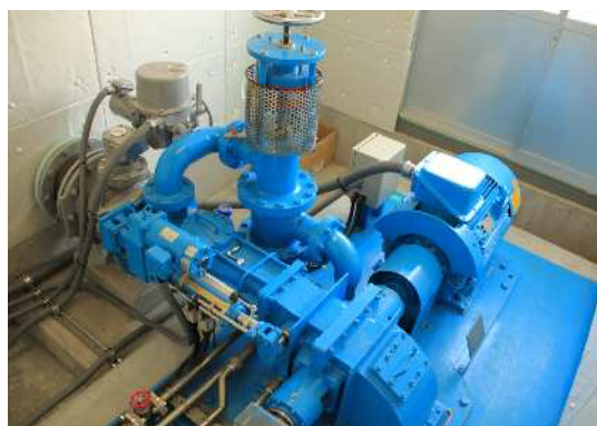
図 2-27 クロスフロー水車（白川発電所）
