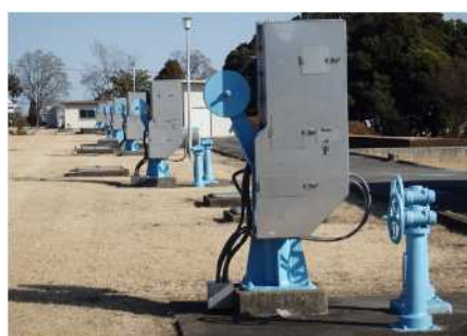
若田浄水場内緊急遮断弁
