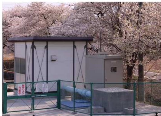
図 2-26 白川発電所（小水力）
