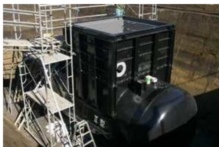
図 2-15 耐震性貯水槽
