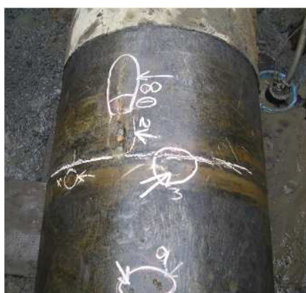
既設管 1000mmの腐食状況
