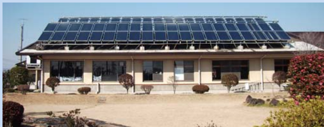
太陽熱温水パネル設置状況
