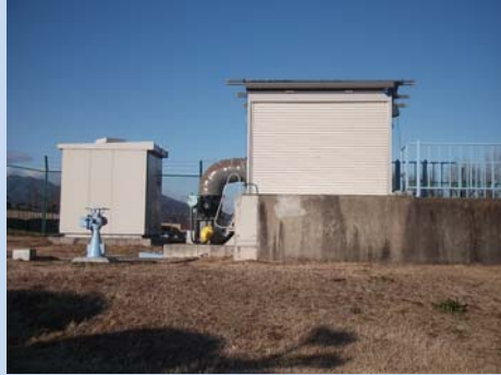
水力発電全景
