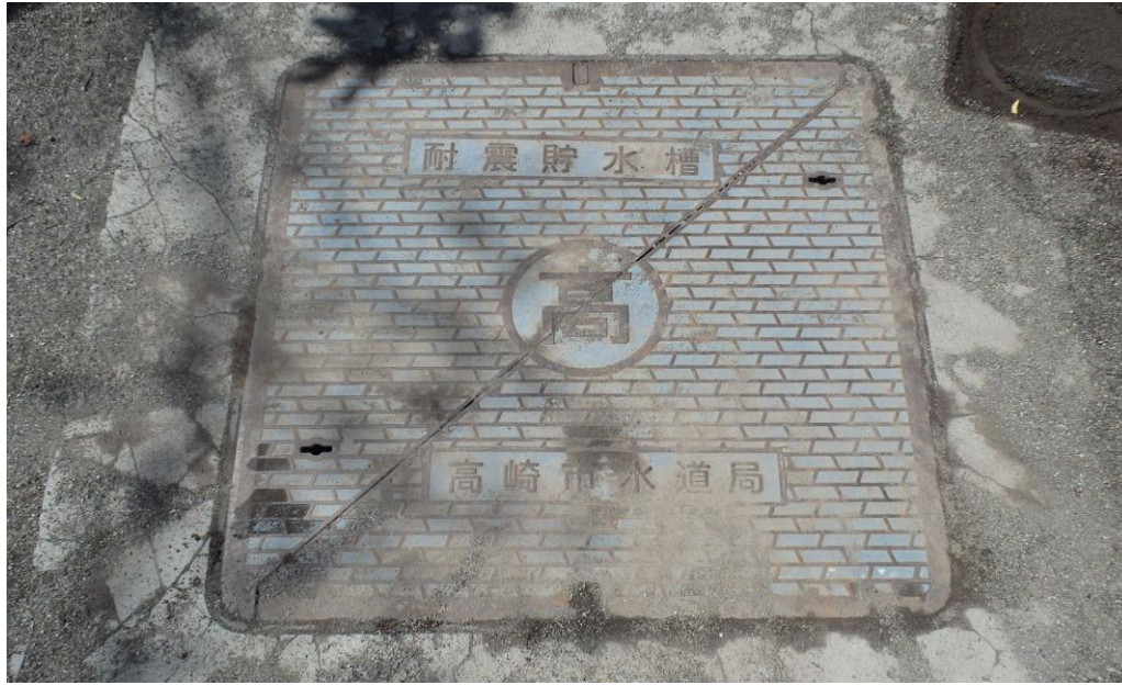
耐震性貯水槽
