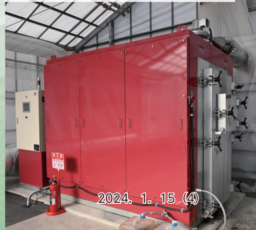
地域の間伐材でハウス内を暖めるバイオマスボイラー
