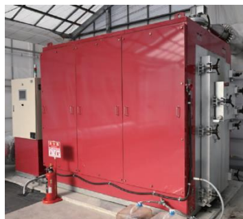
地域の間伐材でハウス内を 暖める薪ボイラー
