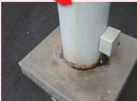
ポールの根元にサビが発生
