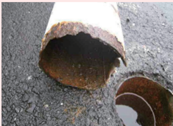
ポールの根腐れによる倒壊
