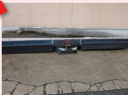
落下した欄間看板
