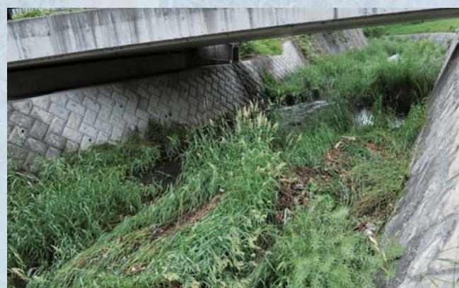
土砂や草が堆積する粕沢川。管理する県と対応を協議
