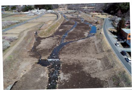
堆積した土砂を撤去した榛名白川
