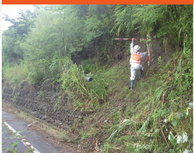
道路脇のり面が崩れた痕を確認。復旧工事を実施予定
