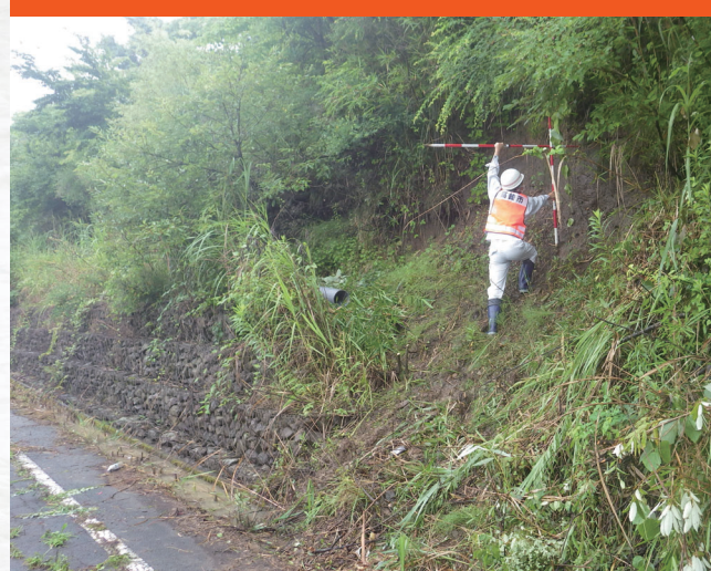
道路脇のり面が崩れた痕を確認。復旧工事を実施予定
