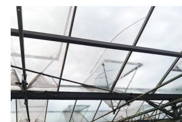
ガラスの割れた農業用ハウス
