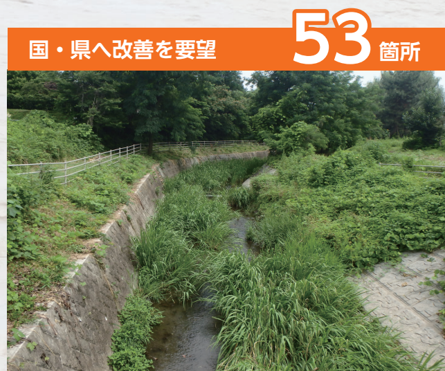
堆積した土砂の撤去や雑草の除去など、改善を要望
