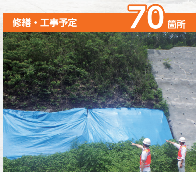
のり面が崩落する恐れがあるため、早急な補修工事が必要なことが判明
