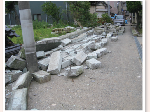
倒壊した塀が避難や救助の妨げになることも
