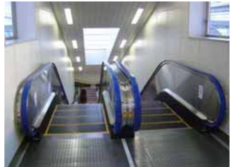
高崎駅構内に設置されたエスカレーター
