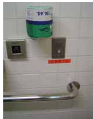
呼び出しボタンの位置が高く、転 んだ時に押せない（公共施設）
