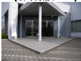
入口前の鋭角な段差
