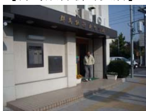
建物出入口 (誘導ブロックなし、段差あり)
