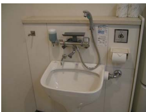
オストメイト設備
