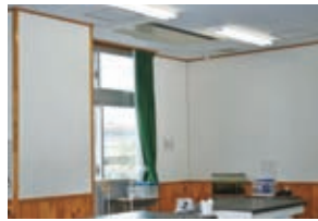
特別教室に設置する空調設備
