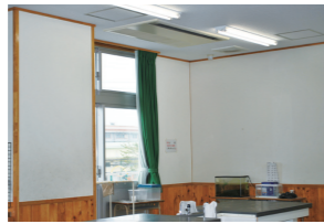
特別教室に設置する空調設備
