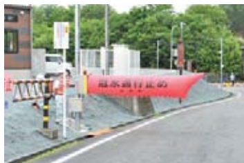
設置したエア遮断機
